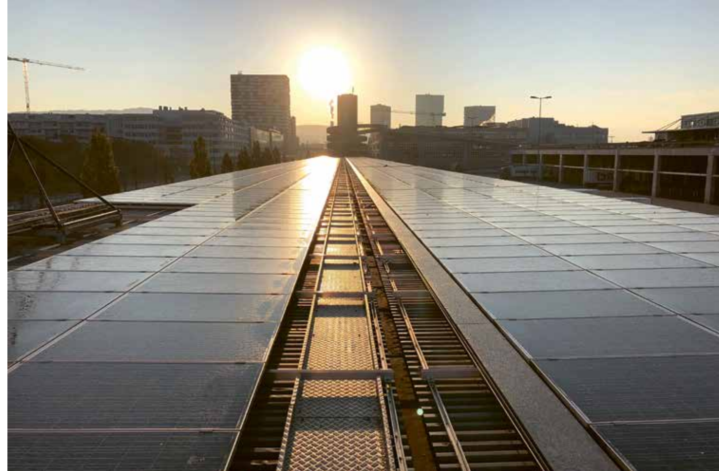
Photovoltaikanlage auf dem Dach des Produzentenmarktes.
